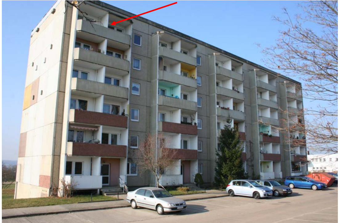
Foto 9: Blick auf die in Richtung des geplanten Stadions im Plangebiet zeigende Ostfassade (Pfeil) des Wohngebäudes IO 9 „Carl-Goerdeler-Straße 46“.
