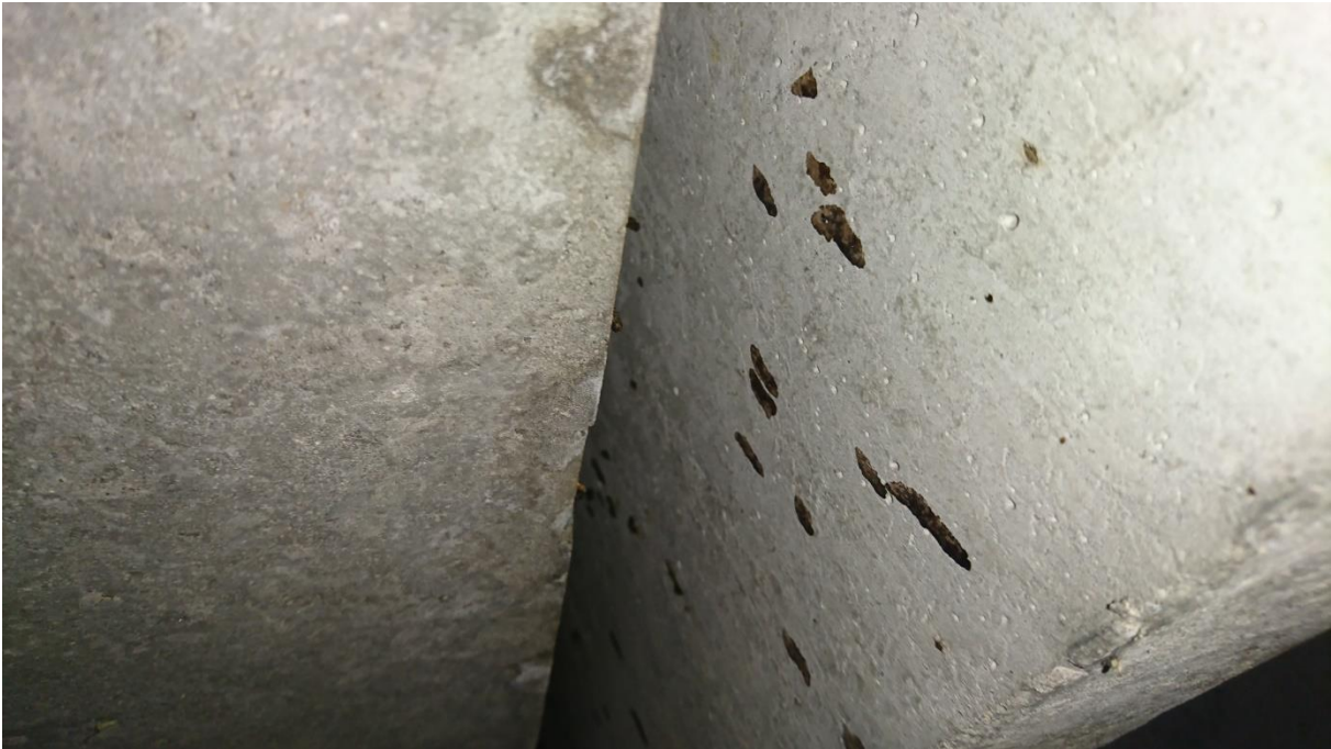
Abbildung 9: Fledermauskot zwischen Deckenplattenspalten
