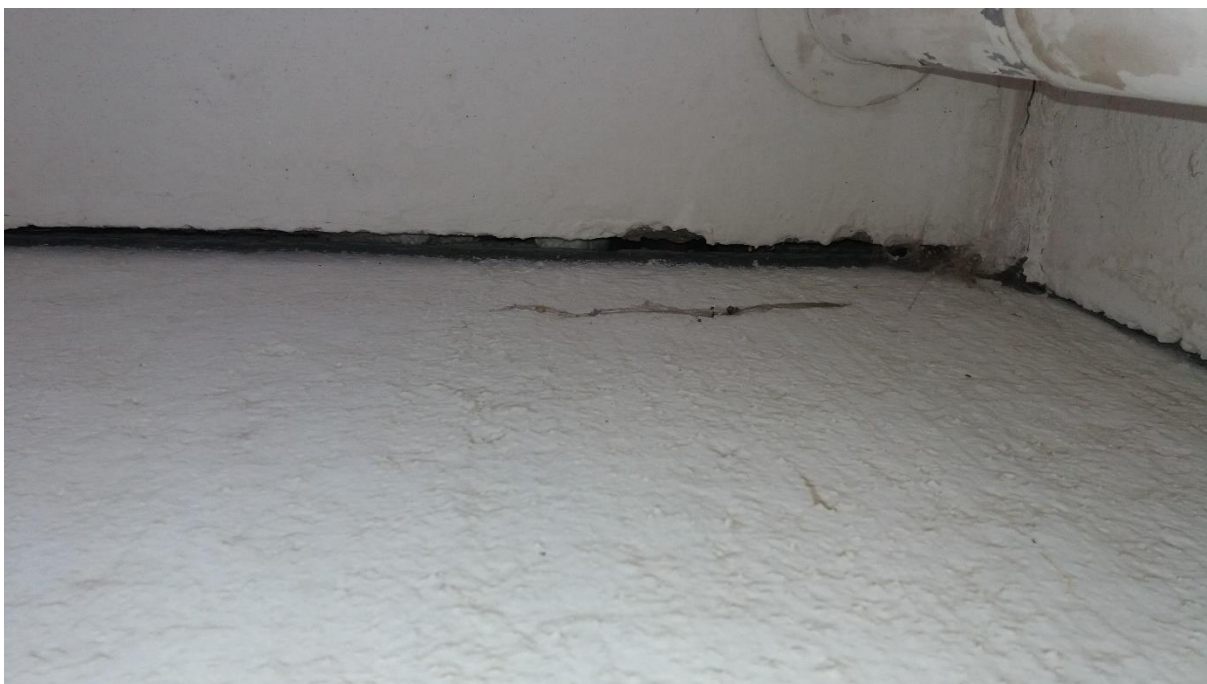
Abbildung 6: Teil einer Balkondeckenspalte
