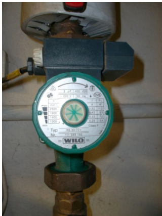
Vierstufige Umwälzpumpe (54...113 W), nicht gedämmt
