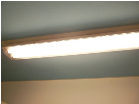
Überwiegend T8-Leuchtstofflampen in Gehäuse mit diffuser Lichtverteilung
