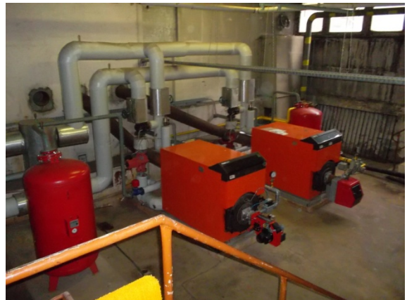
Zwei 384 kW betriebene Erdgas-Kessel von 1991 mit modernen Brennern (2010)
