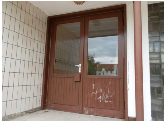
Zuglufterscheinungen der überwiegend mit Holzrahmen installierten Hauseingangstüren
