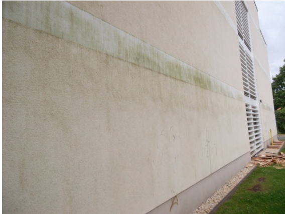
Abnutzungserscheinungen an der gesamten Gebäudehülle
