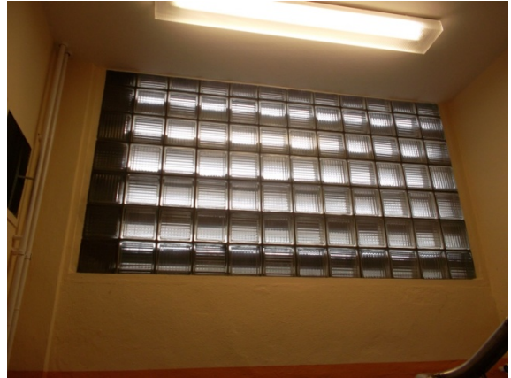
Hohe Wärmeverluste über die Glasbausteine; T8-Leuchstofflampen ohne Präsenzmelder
