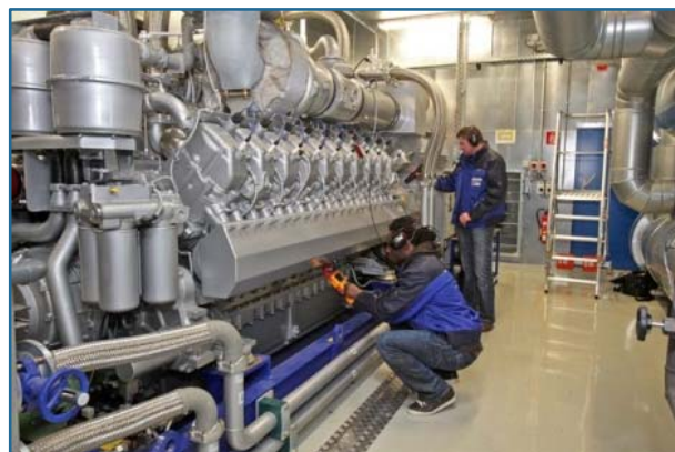
Abbildung 4-3 Blockheizkraftwerk Neuplanitz (ZEV 2012)
