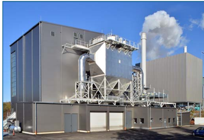
Abbildung 4-4 Neues Biomasseheizkraftwerk an der Reinsdorfer Straße (SV Zwickau 2012)
