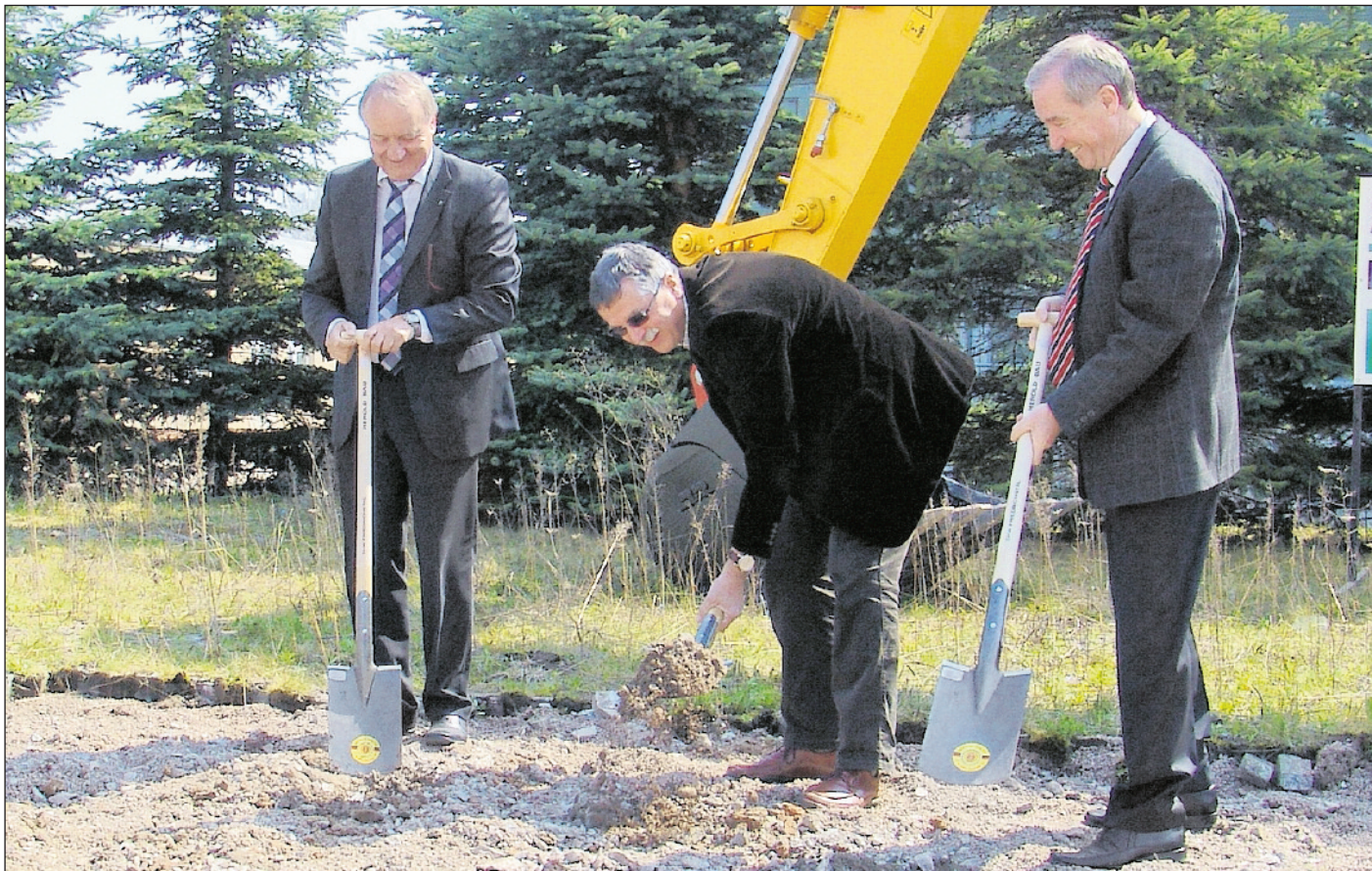
SYMBOLISCHER AUFTAKT FÜR EINE WIRTSCHAFTSFÖRDERNDE MASSNAHME: FRIEDHELM NAGEL (GESCHÄFTSFÜHRER HOPPECKE BATTERIEN), BÜRGERMEISTER RAINER DIETRICH UND MATTHIAS HORN (WERKLEITER JOHNSON CONTROLS SACHSEN-BATTERIEN) BEIM SPATENSTICH. FOTO: STADT ZWICKAU
